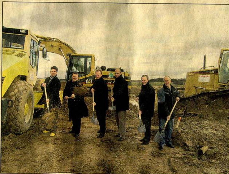
Spatenstich (von links): Peter Thalmann, Klaus Holaschke, Thorsten Ulbrich, Gunter Schwarz und die Vertreter der Baufirmen. (Foto: Peter Boxheimer)
